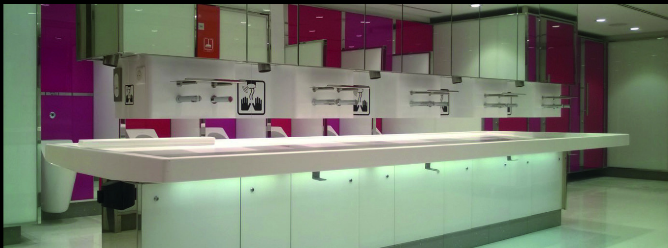
Sanitaires Aéroport BSO ADP / Fabrication : LCCA / Photo : PM / Référence du réseau ATI.
